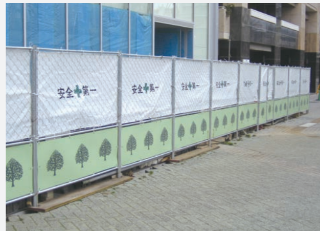
ガードフェンス / 防音シート 単管パイプ / クランプ
